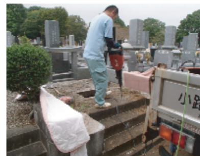
千葉県からの墓所移設工事で現地外柵解体工事時の一枚です。
