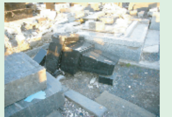
東日本大震災の津波の被災地では地震に強い接着材を使用しても根元から倒れているお墓が多数見られました。
